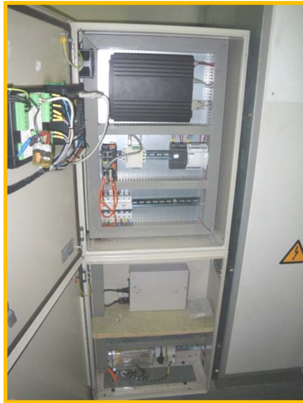
Foto 6: Vista interior de armarios de equipos Sotavento.
