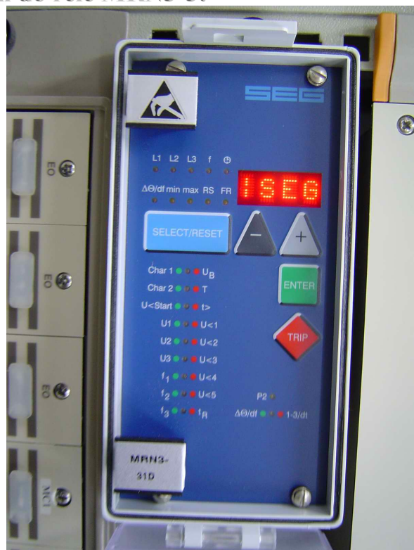
Foto da instalación do relé MRN3-3:
