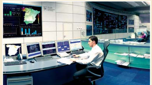
Centro de control de energías renovables (Cecre) integrado en el Centro de control eléctrico (Cecoel).
