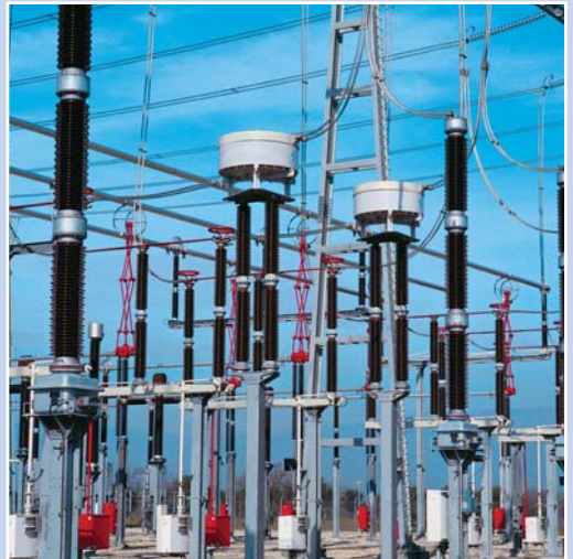
Detalles de los sistemas utilizados en las subestaciones para gestionar el tráfico eléctrico
