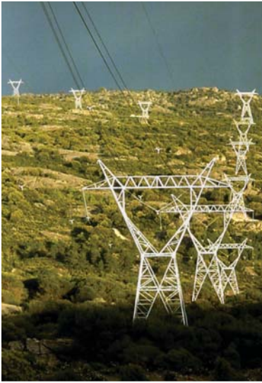
Transporte de electricidad en líneas de alta tensión
