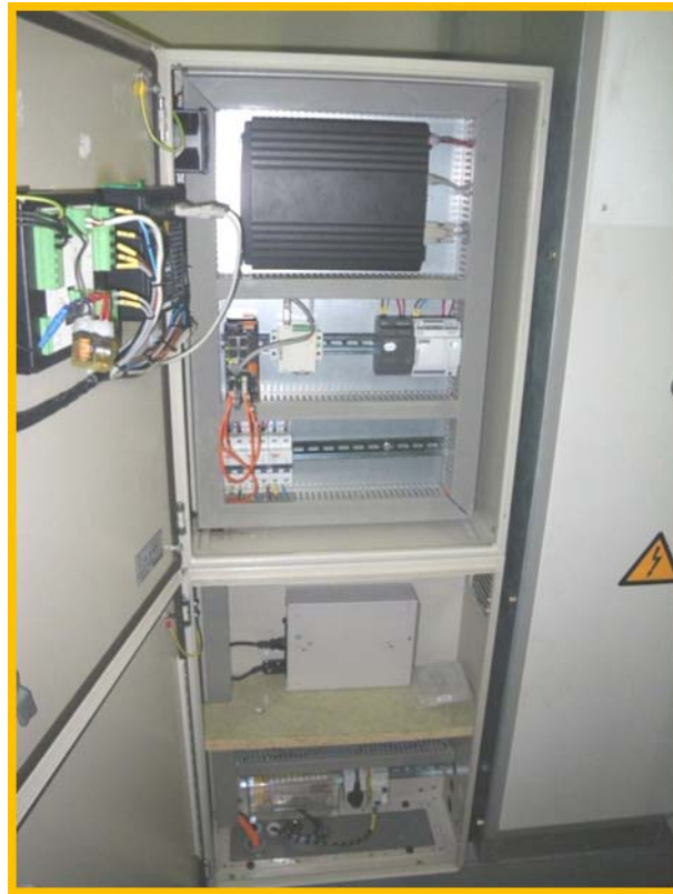
Foto 6: Vista interior de armarios de equipos Sotavento.
