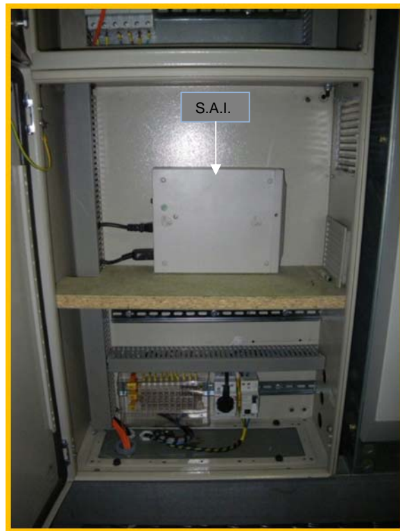
Foto 7: Vista interior armario inferior
