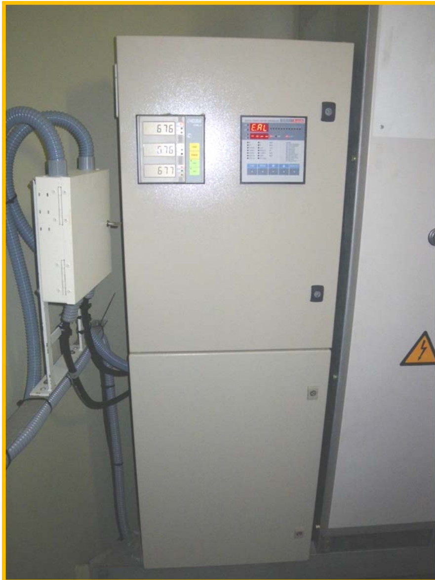
Foto 5: Vista exterior de armarios equipos Sotavento.
