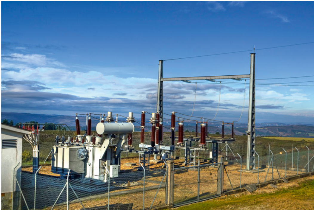
Figura 10 Exterior de la subestación eléctrica del parque
