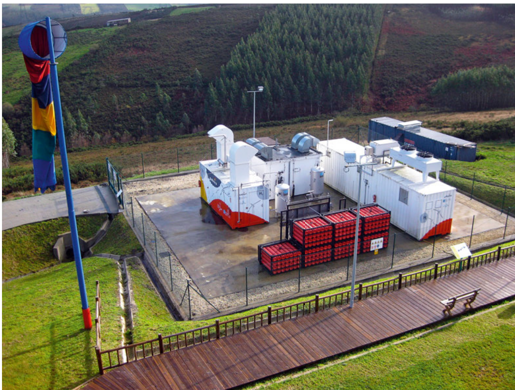
Figura 5 Planta de generación y acumulación de energía en forma de hidrógeno
