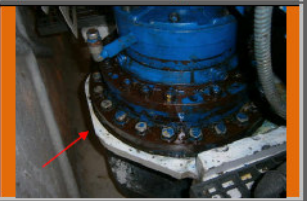
Fuga de aceite reductora de giro.
