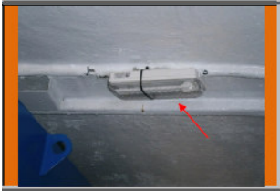
Una luminaria de la Nacelle no funciona.
