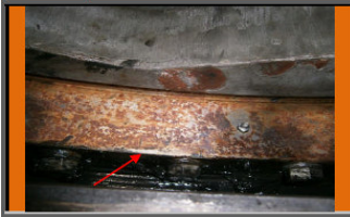
Oxidación pista interna Corona de Giro.
