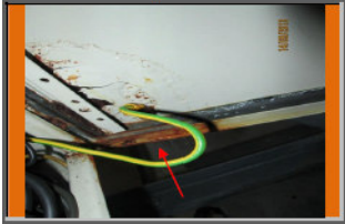
Oxidación armario Top.
