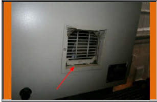
Falta filtro armario Top.
