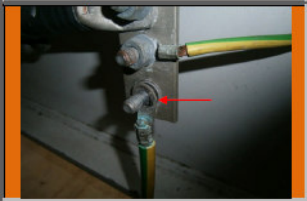
Falta tuerca puesta a tierra Central Hidráulica.
