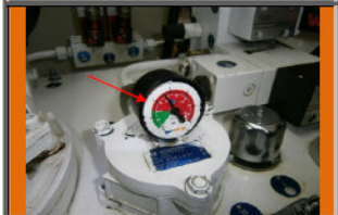
El manómetro de la Central Hidráulica está roto.
