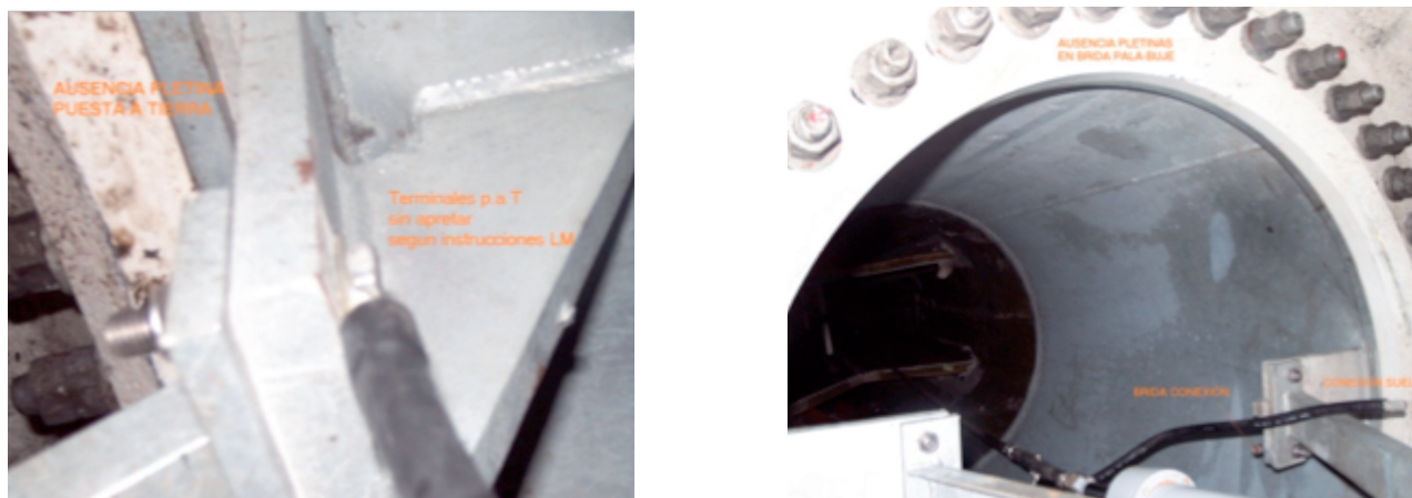
Figura 1. Carencias detectadas en el sistema de protección frente a descargas atmosféricas en AE-17.
