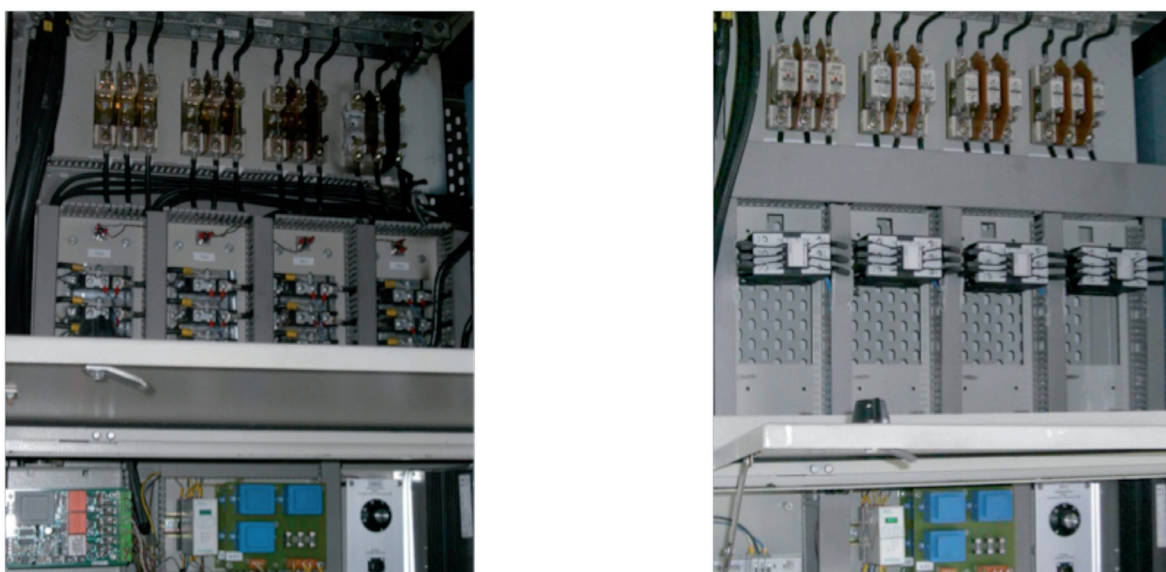
Figura 10. Estado inicial (izquierda) con tiristores y reformado (derecha) con contactores, MADE AE46.
