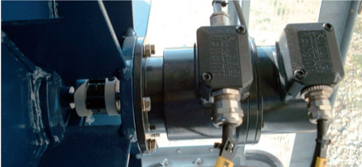
Figura 8. Sistema de anillos rozantes en turbina G47.
