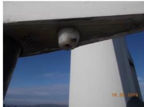
Foto 14: Cono BS dañado
