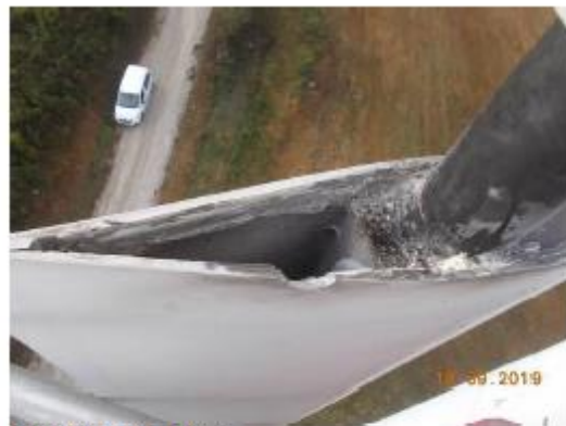
Foto 6: Daños en VS
